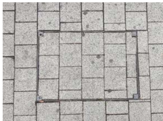
Сн. 150 Интегрирана настилка от бетонни павега в правоъгълен капак на шахта. [София, зона 2]
