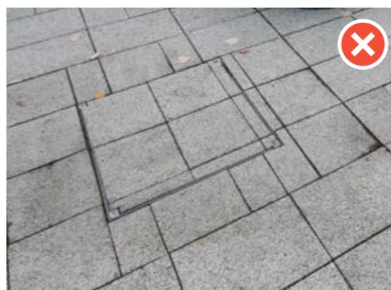
Сн. 148 Интегрирана настилка от бетонни плочи в правоъгълен капак на шахта. Да се избягва употребата на малки парчета от настилка около и в капак на шахтата, когато настилка не е залепена за основата. [Враца]
