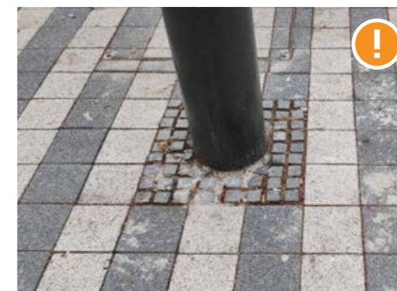
Сн. 167 Рязане и редене при елемент с кръгло сечение. Препоръчва се залепване на каменните павеа за основата, за да се предотврати разместване и отделяне на цели елементи. [София, зона 2]
