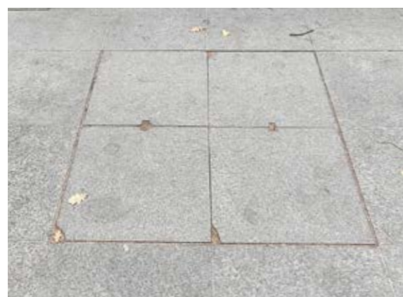
Сн. 146 Интегрирана настилка от каменни плочи в правоъгълен капак на шахта. [София, зона 2]
