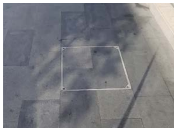
Сн. 145 Интегрирана настилка от каменни плочи в правоъгълен капак на шахта. [Варна]
